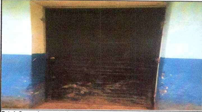
Foto 1: Se requiere mantenimiento de puerta, lijado, cepillado, aplicado pintura y sustitución de chapa Yale.
