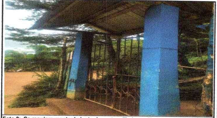
Foto 2: Se requiere mantenimiento de porton, lijado cepillado y aplicación de pintura, se encuentra en mal estado.
