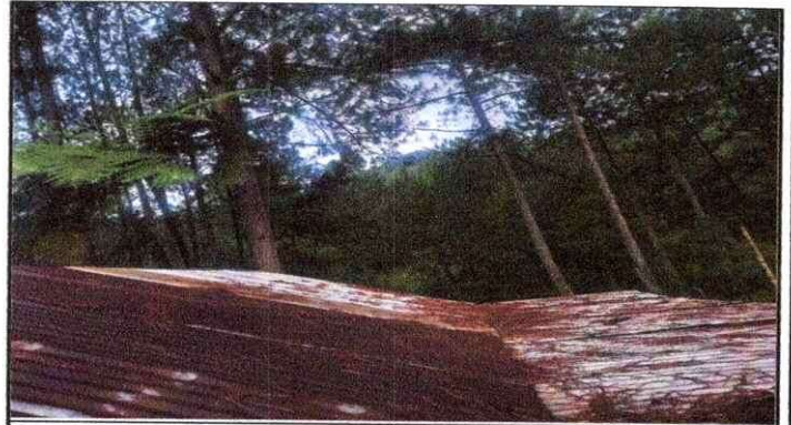
Foto 4: Sustitución de techo, se requiere el cambio de techo.
