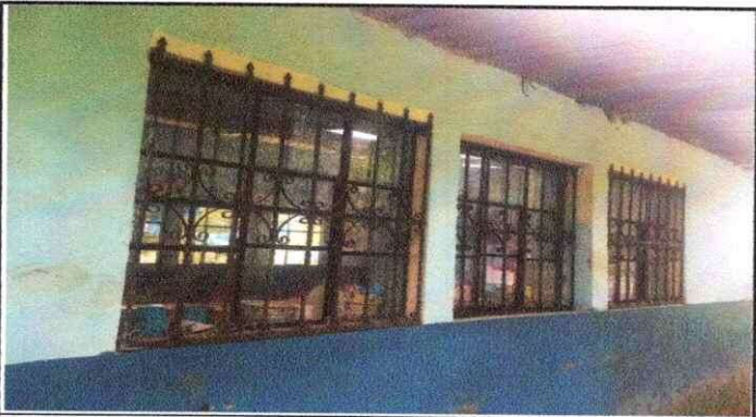
Foto 3: Se requiere sustitución de balcones, debido a que se encuentran en mal estados.
