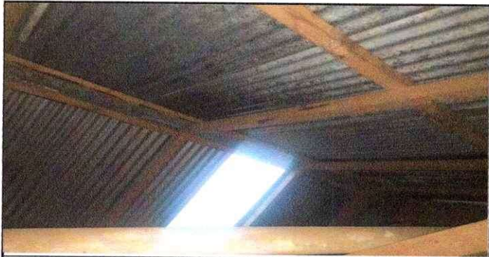
Foto 5: Se requiere sustitución de estructura de soporte de techo metálico.
